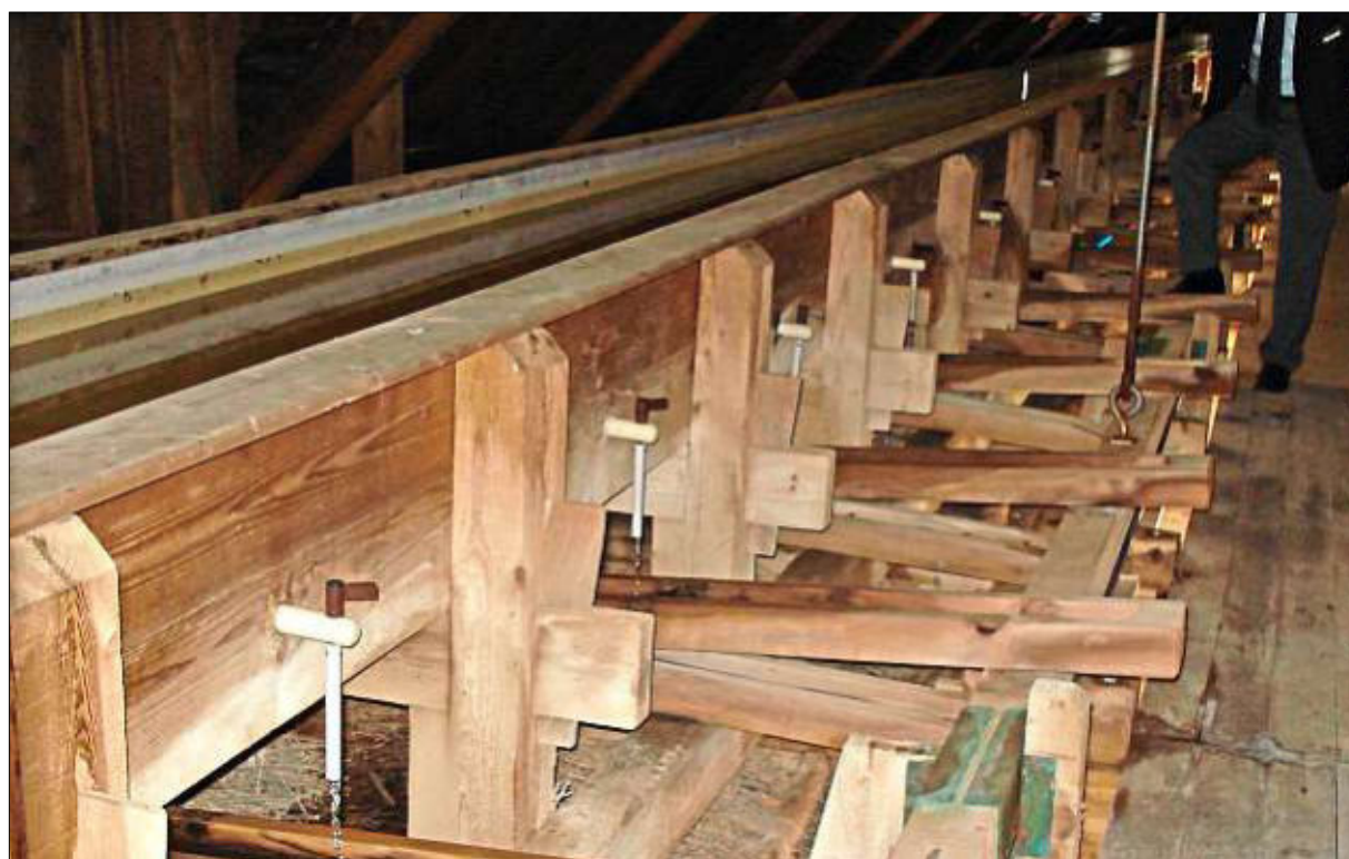
Blick in das Dachgeschoss des Gradierhauses mit der alten Technik. – Foto: Hirsch
